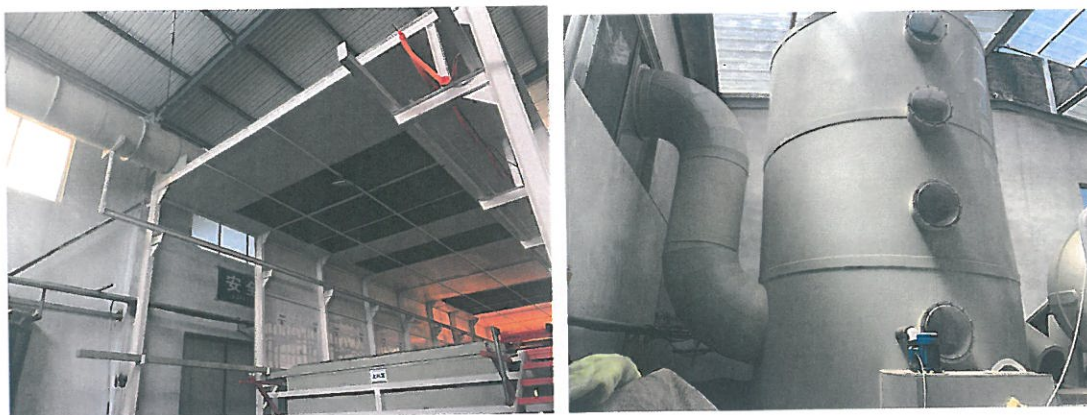
图 4-1 废气治理设施
